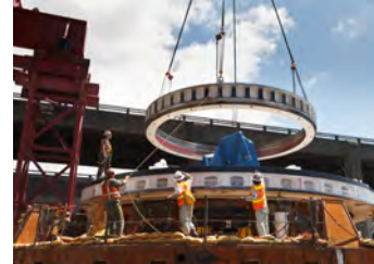
Đội ngũ xây dựng đang lắp đặt một phần hệ thống đệm kín hơi mới được thiết kế lại để bảo vệ ổ trục chính mới của máy.
