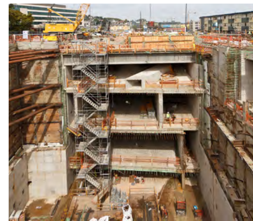
Công trình xây dựng tiếp tục tại hố tiếp nhận máy đào hầm.
