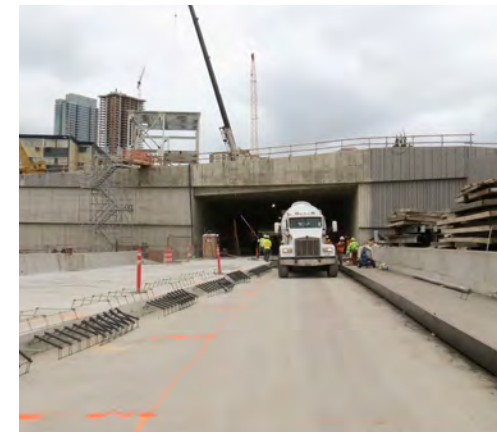
Cuadrillas pavimentaron la futura calzada con dirección hacia el sur a la altura del portal norte.
